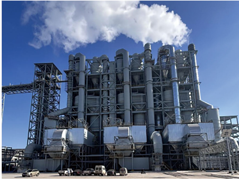
大型高效氧化鋁氣態懸浮焙燒爐
