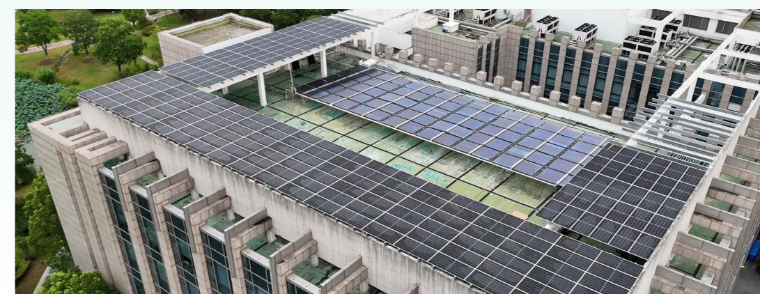
江蘇省分行方山園區屋面光伏組件陣列。
