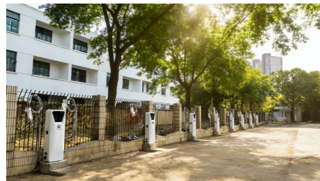
大眾綠行東葛路車站充電場站項目
