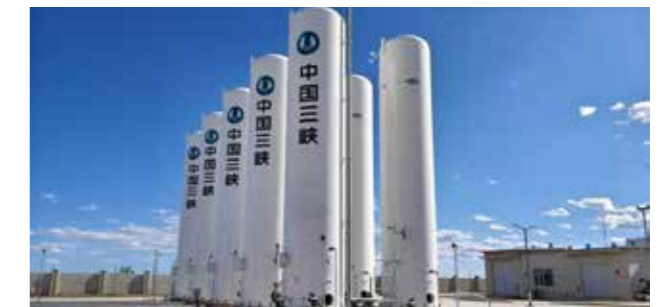
乌兰察布绿电制氢综合示范项目 3Mpa 低压储氢区
