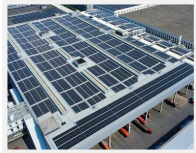
九号科技有限公司屋顶光伏
