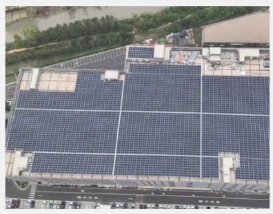
纳恩博（常州）科技有限公司屋顶光伏
