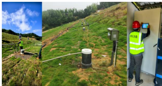
公司自主研发的尾矿库浸润线（渗流场）智能监测控制系统已完成成果转化并投入市场应用，有效提升尾矿库安全监测与预警能力
