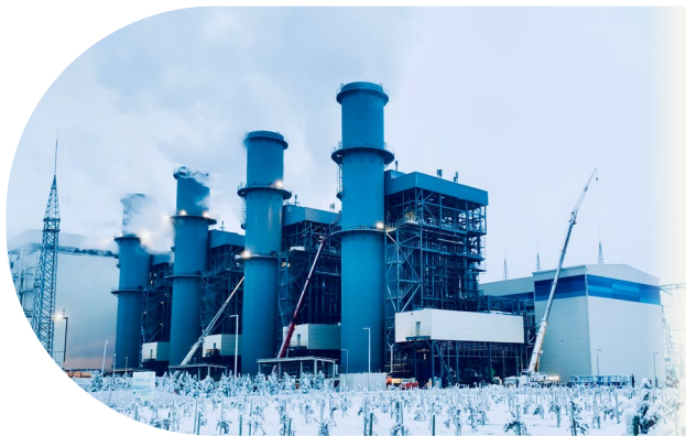
阿塞拜疆明盖恰瓦尔联合循环项目正式投运，东方电气为该项目提供四台F级余热锅炉及其附属设备。
