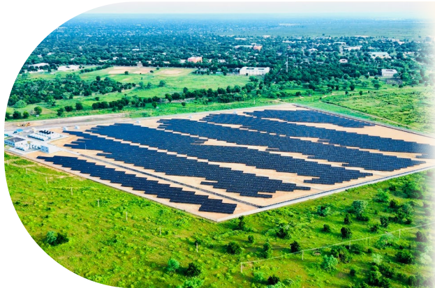
尼日利亚最大的柴光储综合能源项目正式投入商业运行，该电站的建成投产不仅有效缓解当地电力紧张局面，更为当地可持续发展注入强劲动能。
