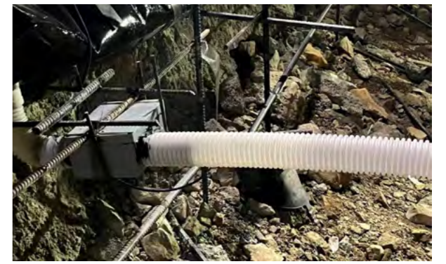
招商交科隧道地下水排放智能控制系统 Tunnel groundwater discharge intelligent control system of CMCT
