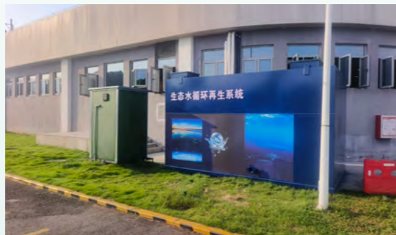
甬台温高速生态水循环再生系统
