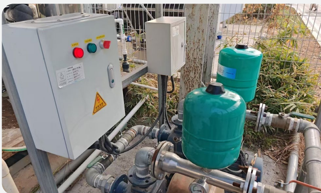
检测中心回水利用
