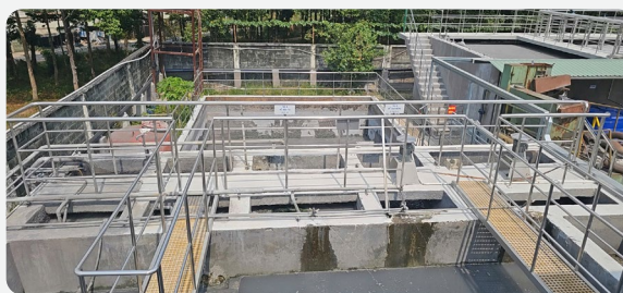
污水处理设施
