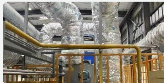
烧结炉余热回收装置
