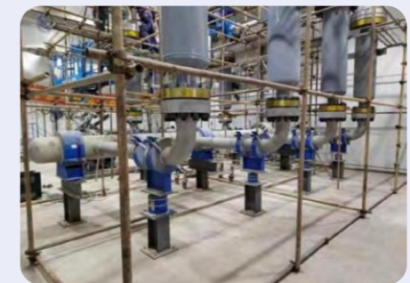
高温镍基合金主气管道
