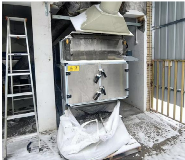
公司新购污泥干化机，实现污泥减量
