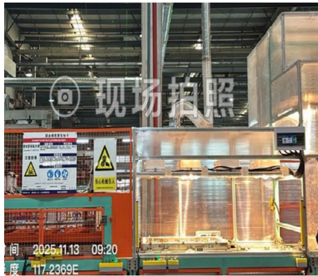
公司新增点胶机环保设施，将气体无序排放提升为收集处理后排放
