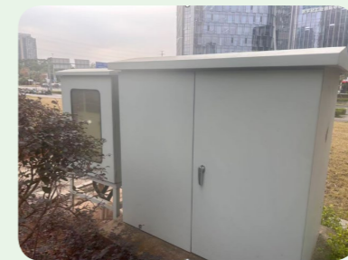
深圳欧菲光项目雨水回收系统
