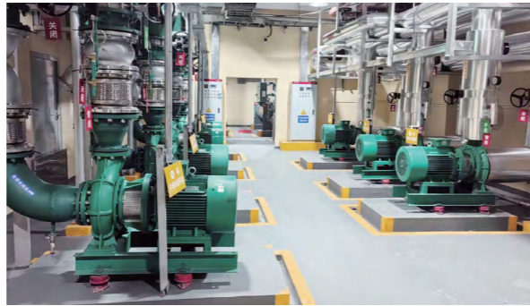
高能耗设备改造后
