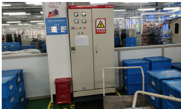
整改前：配电柜前有杂物
