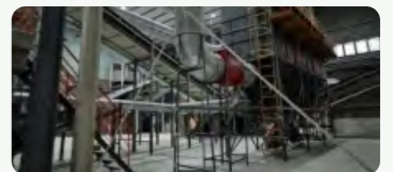
综合利用厂除尘设备
