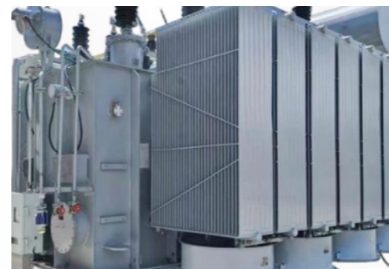
630KVA 变压器容量
