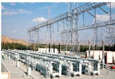
▲ 国内首套 800kV GIS 产品应用于我国首条 750kV 输变电工程—官亭变
