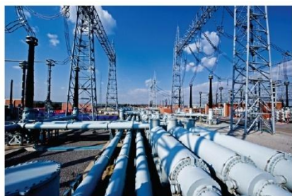
▲ 国内首套 1100kV GIS 产品应用于我国首条特高压示范工程—晋东南站
