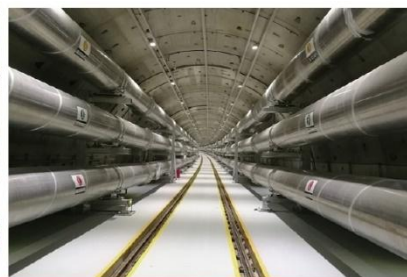
▲ 国内首套 1100 kV GIL 产品应用于苏通 GIL 管廊工程
