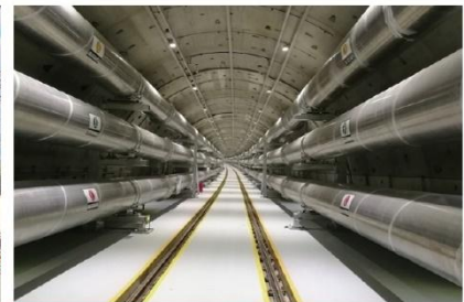
▲ 国内首套1100 kV GIL产品应用于苏通GIL管廊工程
