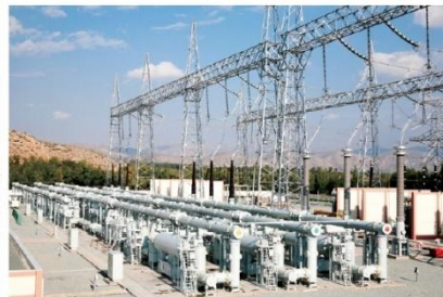
▲ 国内首套800kV GIS产品应用于我国首条750kV输变电工程—官亭变
