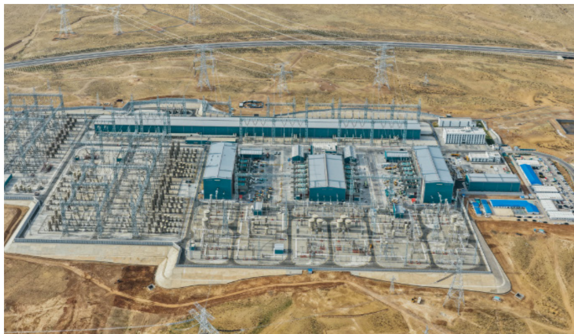
宁夏 - 湖南 ±800 千伏特高压直流输电工程
