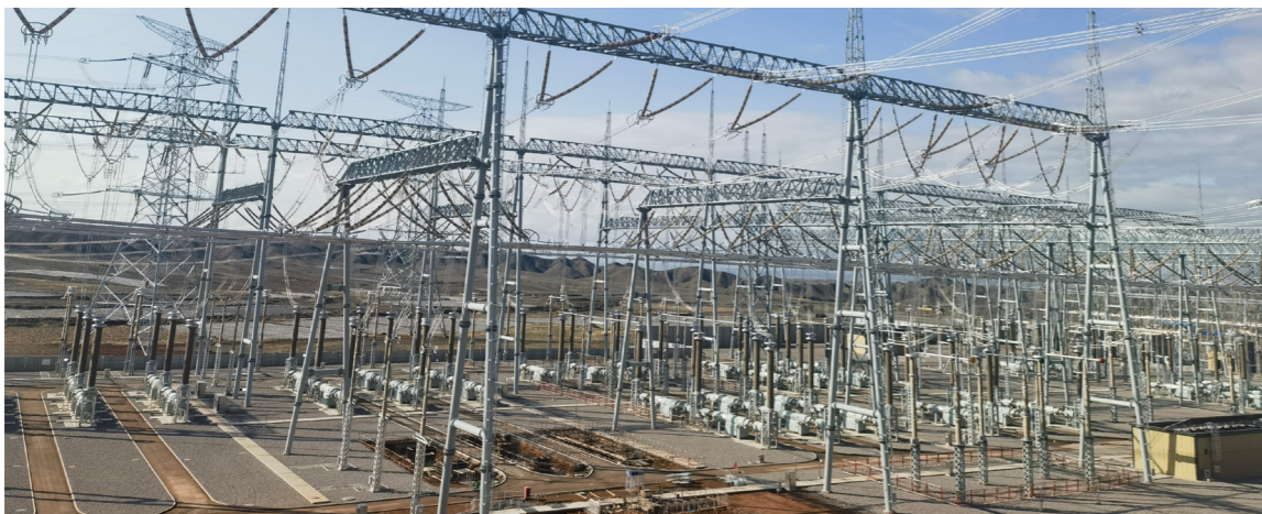
宁夏天都山 750 千伏输变电工程
