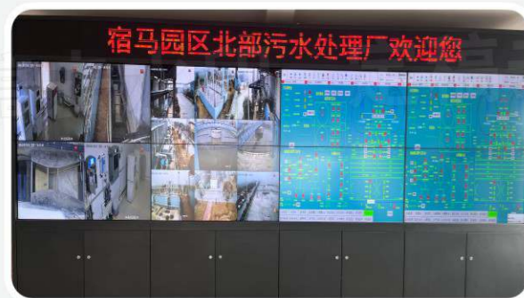
宿马北部污水处理厂自控系统
