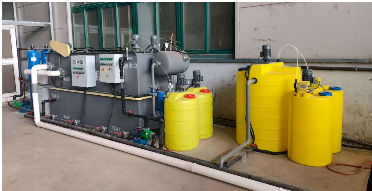
▲ 轴研科技项目生产工艺用水循环
