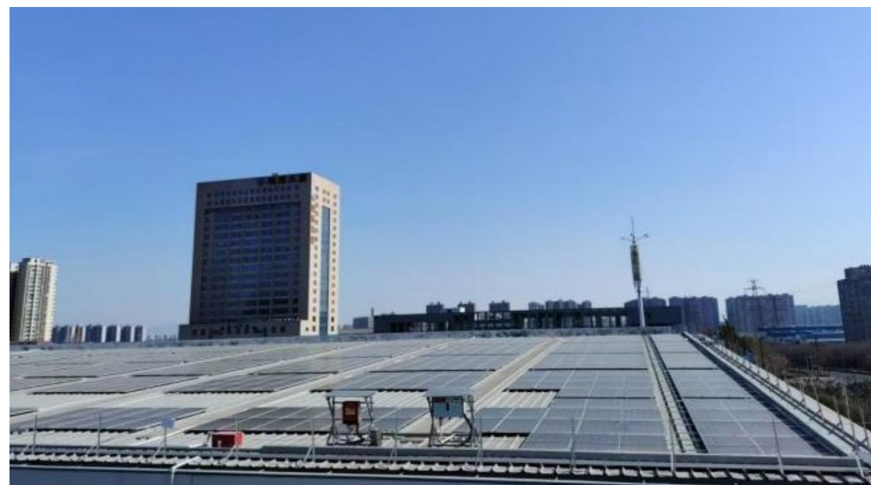
▲ 精密车间分布式光伏发电项目
