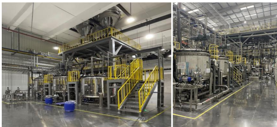
循环式高效制浆系统实景图
