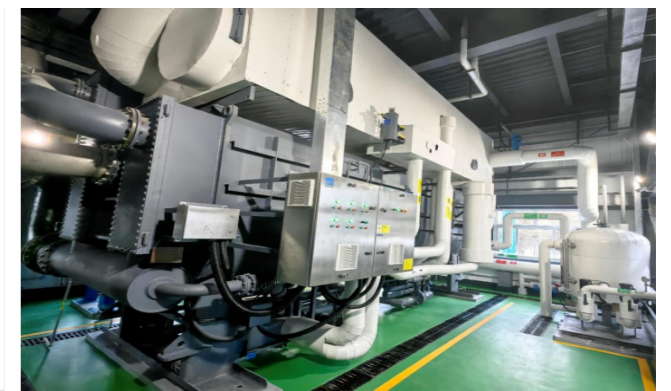
“溴化锂吸收式热泵机组 + 接触式喷淋塔”内外部设备
