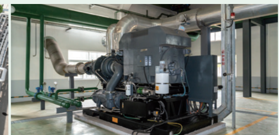
空压机改造项目（恒科新材料）
