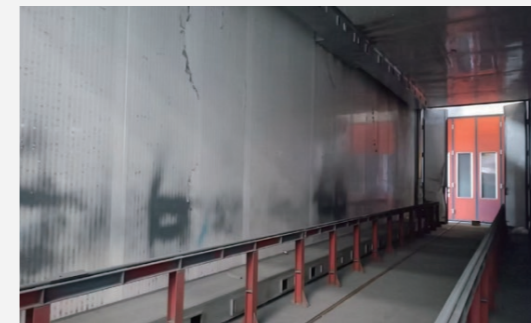
涂装生产线烤漆房余热资源回收
