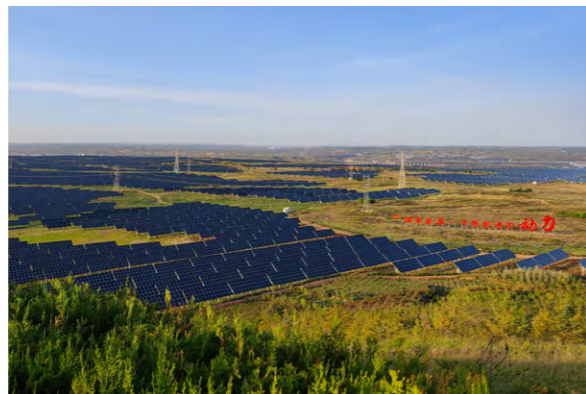
内蒙古白音提布光储电站
