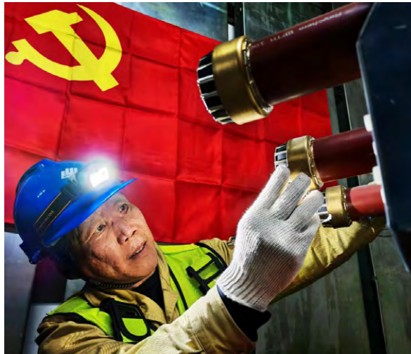
绥中公司工作人员正在对 6kV 开关进行检查
