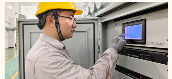
舟山海上风电落实领导带班及关键岗位 24 小时值班，结合风功率预测抢抓发电窗口期，加密巡检频次，强化架空线路、海缆登陆点等重点区域巡查，保障风机安全稳定运行，筑牢双节保供基础。
