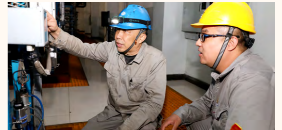
大同公司强化政治保电担当，严格落实领导带班、24 小时值班及信息日报与零报告制度，规范执行操作规程，安全高效完成 10 号机组日间启停，对供热管网、换热器等设备开展“拉网式”排查检修，全力筑牢双节供热保障防线。
