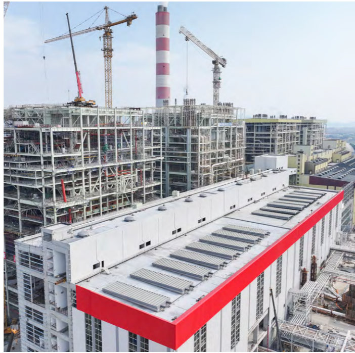
国能浙江北仑电厂一期节能减排改造项目供电煤耗低至 257.24 克 / 千瓦时，年节约标煤 30 万吨、减排二氧化碳 80 万吨；全厂生产用水 100% 由城市中水替代，年节水量超 500 万吨；机组实现 15%—100% 宽幅负荷调节，灵活支撑新能源消纳，入选中电建协 ESG AA 级案例
