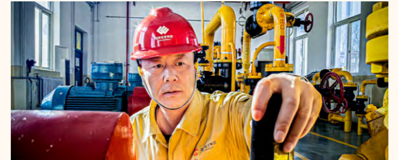
三河公司从隐患排查、设备运维、环保管控、物资储备到应急响应等方面多管齐下，保障电力稳定供应。
