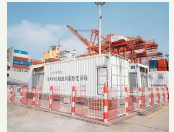
海天码头船舶岸基供电系统
