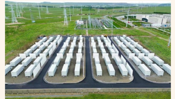
源网荷储一体化项目
