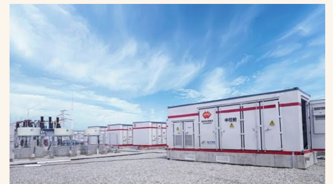
国能青海大柴旦28.97MW/100MWh多种形式复合储能项目
