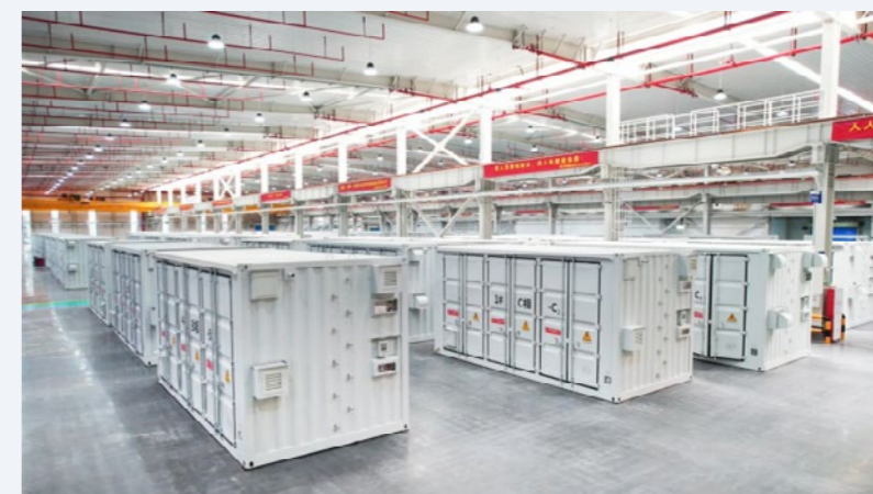
级联型高压技术与半固态电池结合的独立储能电站
