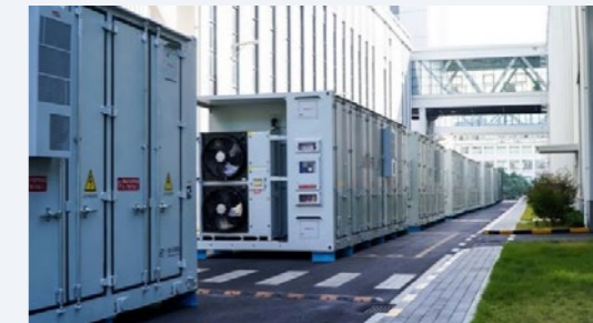
梅州平远二期独立储能电站项目储能系统
