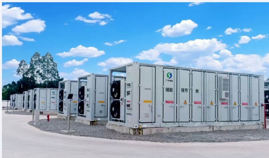
佛山220kv独立储能电站
