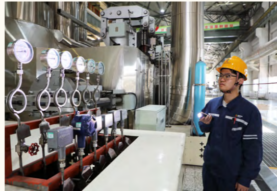
霍林河坑口发电公司集控巡检员对汽轮机顶轴油压进行细致检查
