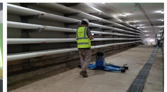
综合管廊中的应用
