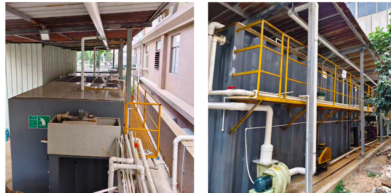
中润污水站扩容改造
