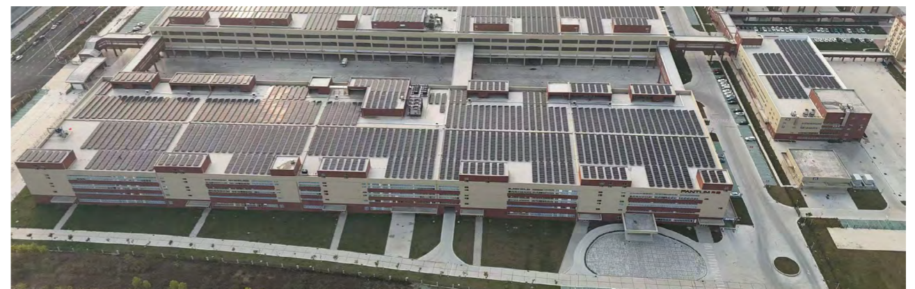
合肥园区光伏发电鸟瞰图
