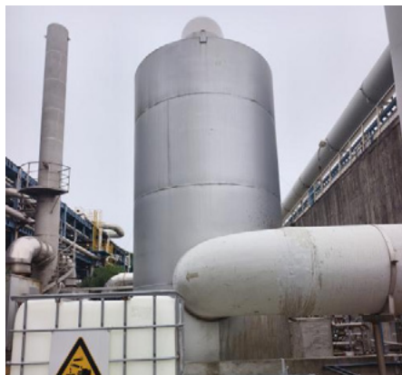
▲ 次氯酸钠喷淋设备
