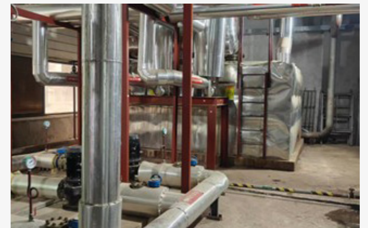
>>> 宁福新能源蒸汽冷凝水余热回收
