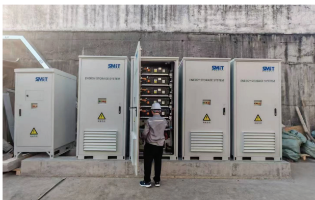
東莞大嶺山工業園區工商儲能項目
