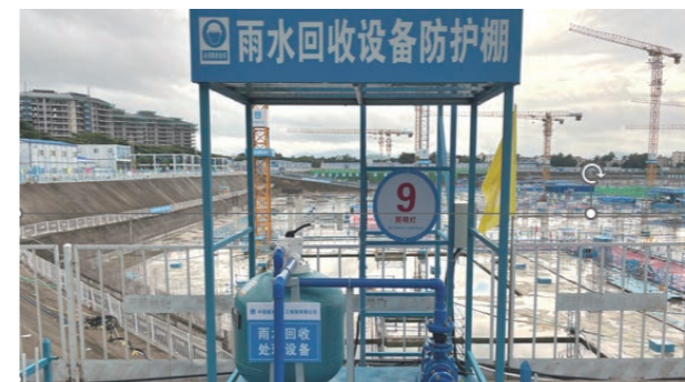
△ 投資公司在在建項目在工地安裝的雨水回收裝置，雨水和施工排水回收利用
