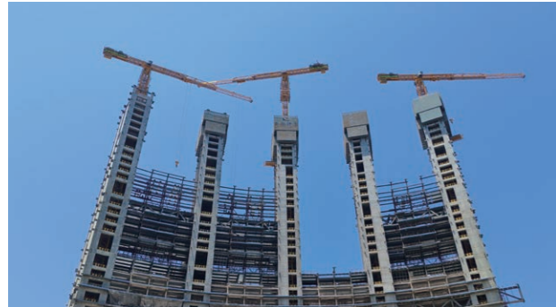
△ 三亞國際免稅城一期酒店項目採用「鋼結構桁架 + 鋼筋樓承板」
