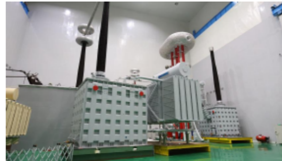
1000kV特高压低噪声电抗器
