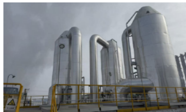
高盐废水处理系统及配套设施
