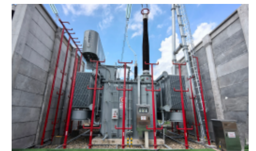
行业首台500千伏植物油变压器投运现场
