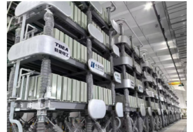
300兆瓦柔性低频交流输电换流阀
