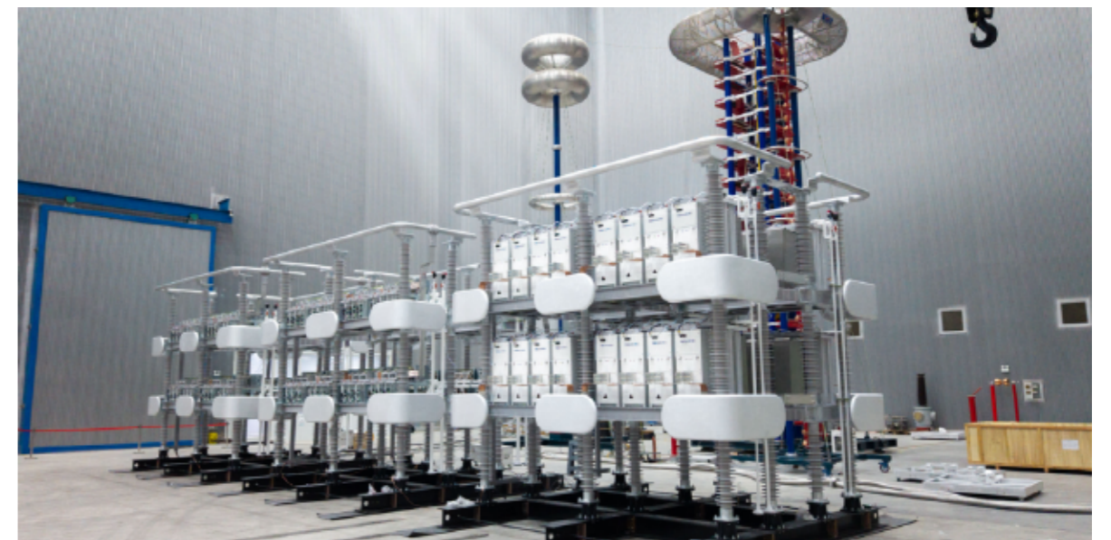
基于IGCT的±50千伏/200兆瓦模块化换向式变换器
