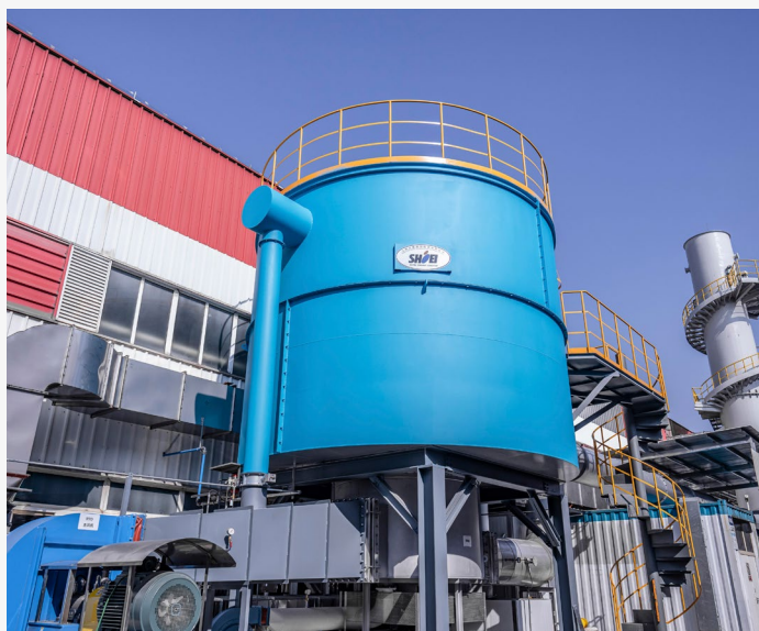
涂装废气处理设施 RTO ▲
