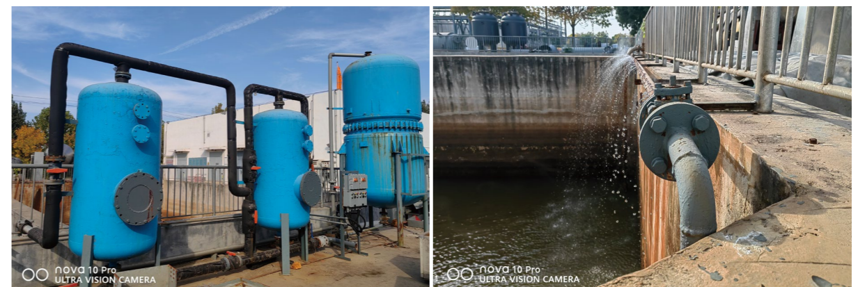
冷凝水回收设备
