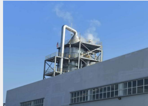
废气处理设施
