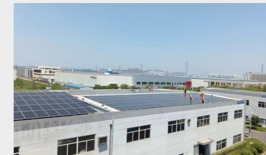
安徽寒锐屋顶光伏发电装置
