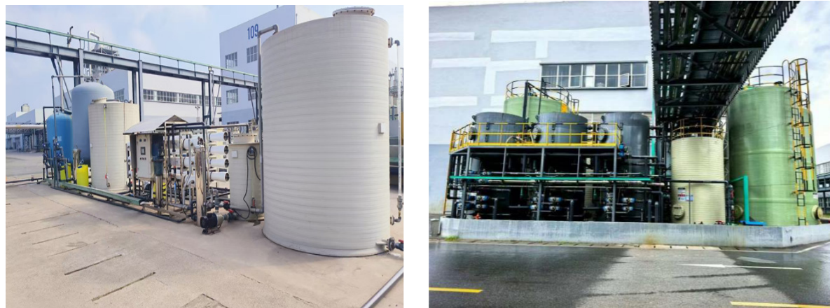
赣州污水处理设施
