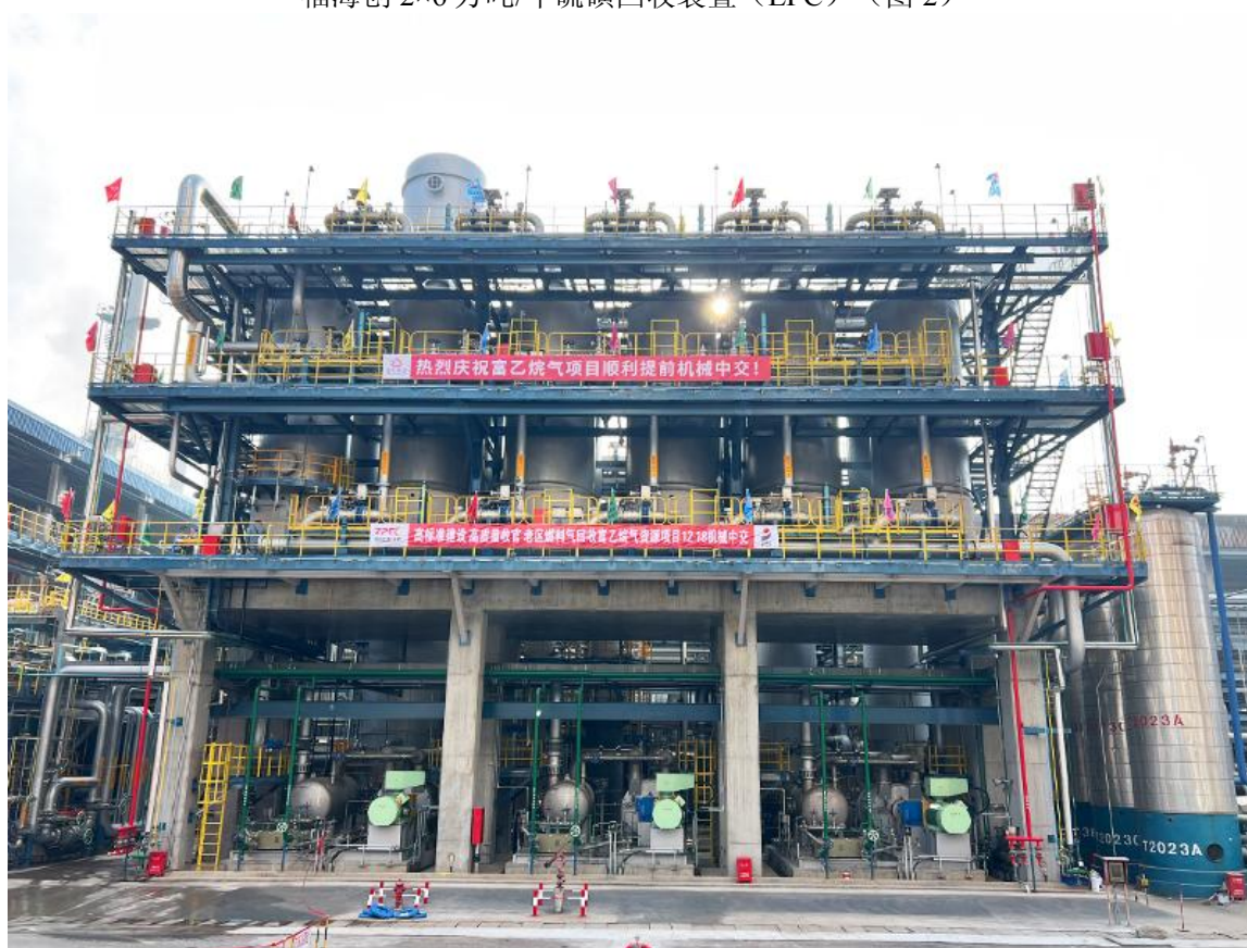
镇海炼化炼油老区燃料气回收富乙烷气项目 (EPC) (图)
