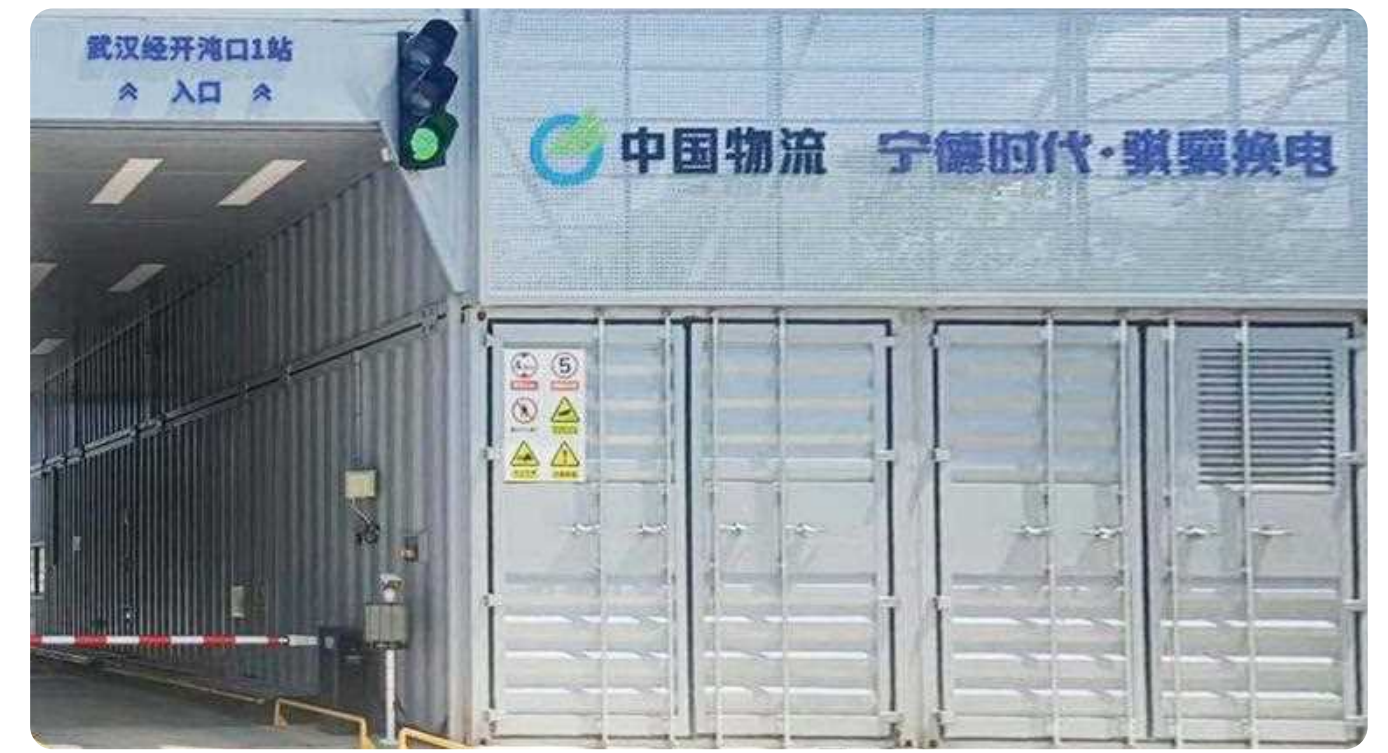
生產基地投建換電站
