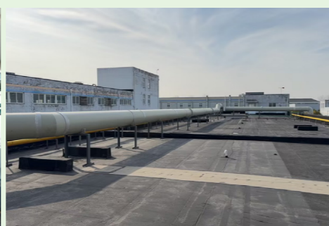
扬州联澳废气收集管道
