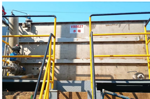
蒸汽冷凝水回收装置
