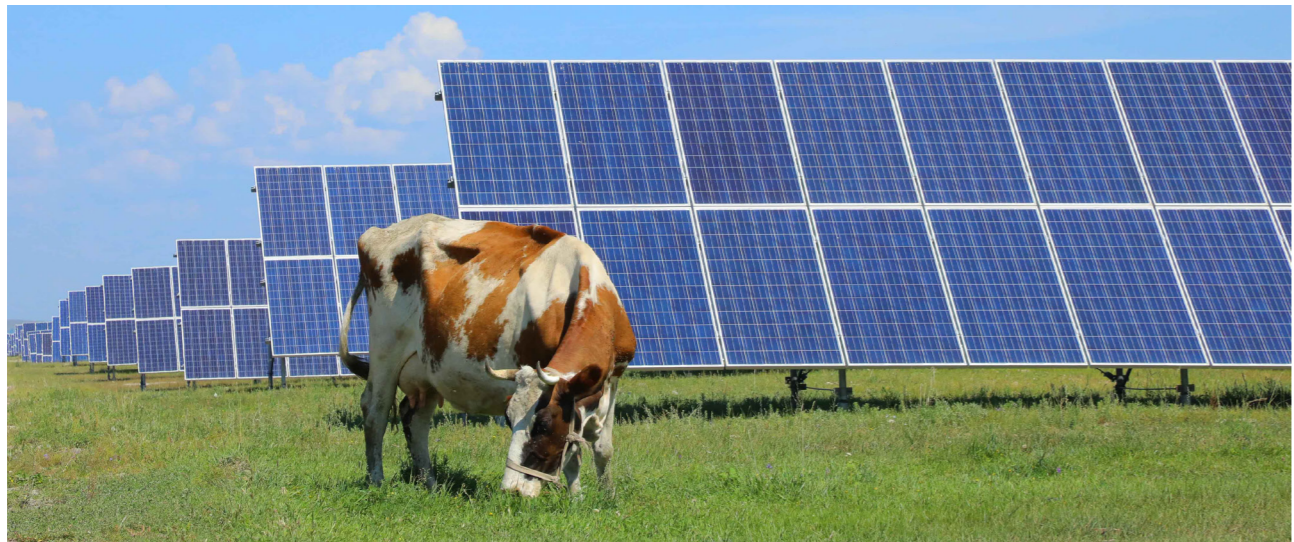
内蒙古满洲里光伏电站
