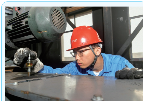
铅冶炼厂设备巡检
