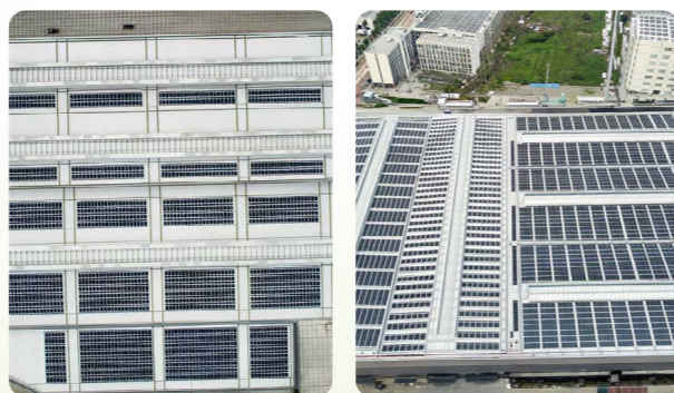
工厂光伏铺装
