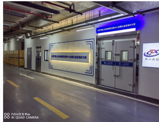
合肥市蜀山区疾病预防控制中心疫苗自动化冷库
