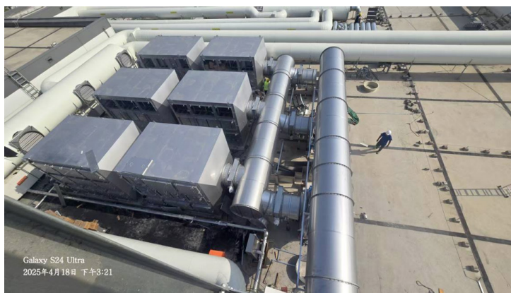
南通通富废气处理设备
