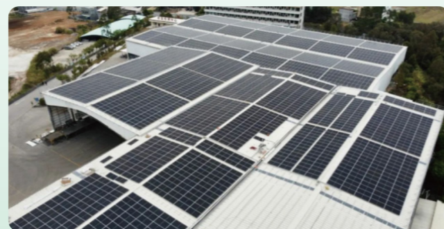
鹰牌东源工厂屋顶光伏
