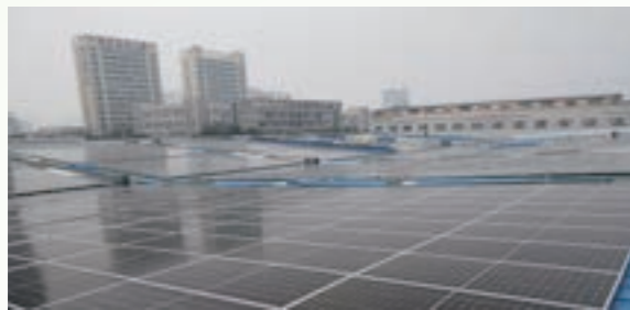
燎旺车灯生产基地厂房屋顶光伏
