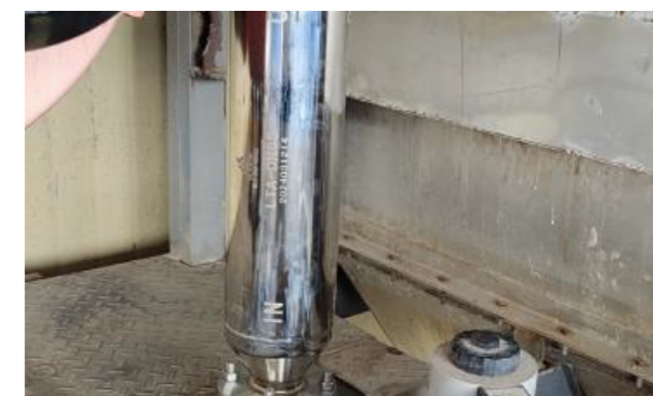
双吉化工—热风炉燃气节能器
