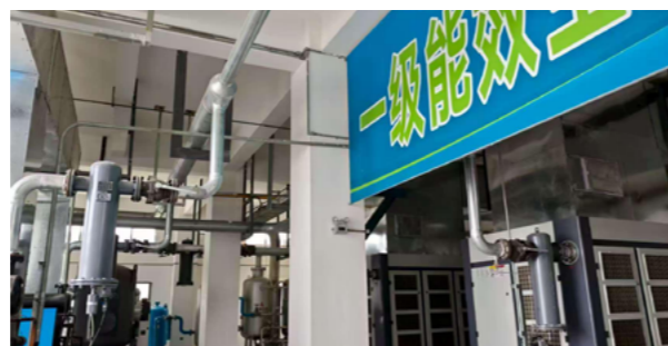
利民化学—一级能效空压站
