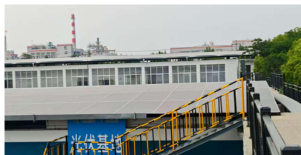
利民化学—光伏项目
