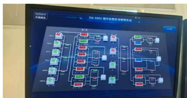
利民化学—循环水系统节能改造
