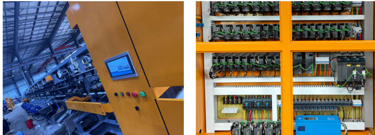
客户现场及应用电柜
